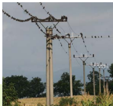
Stĺpy elektrického vedenia, ošetrené ekochráničkou.
