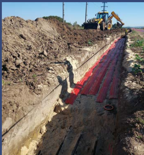
Obr. 4 Zakopanie elektrického vedenia je technicky a finančne veľmi náročné. (ZSD)
