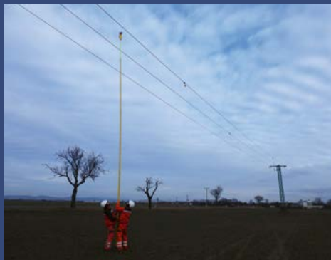
Obr. 7 Inštalácia zo zeme. Rýchly spôsob použiteľný najmä v prípade 22 kV vedení. (M. G.)
