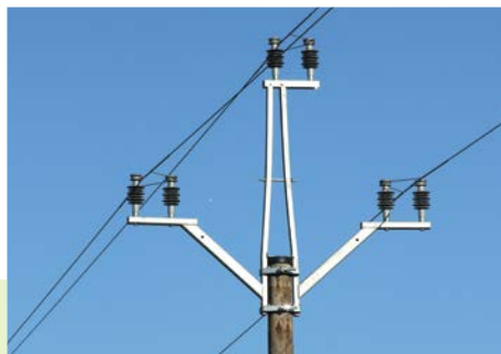
Špeciálna konzola na stĺpe 22 kV vedenia s názvom „anitibird“. Foto: B. Maderič
