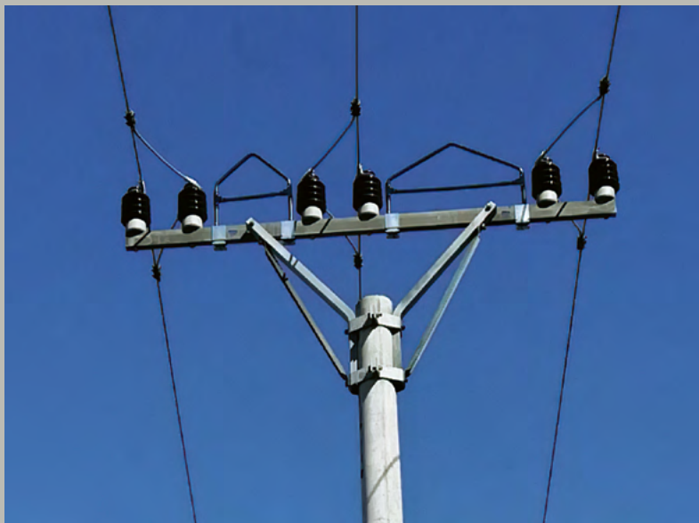
Obr.2. „Ekochránička“ inštalovaná na dvojzávesnej konštrukcii 22 kV stĺpa, zabraňujúca vtákom dosadať do priestoru medzi aktívnymi vodičmi.
